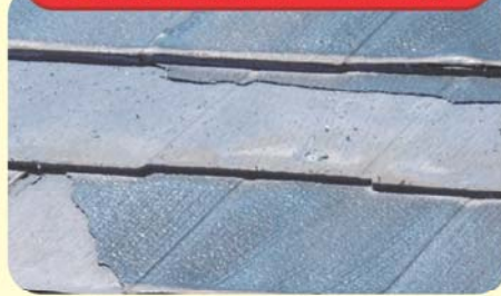
層の剥がれ(スレート屋根)
