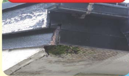
雨漏りによる軒天の腐食
